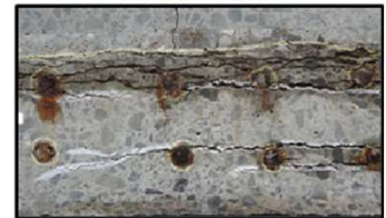
水平ひび割れ
