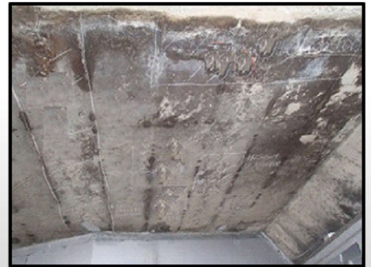
ボックスカルバート頂版の損傷
