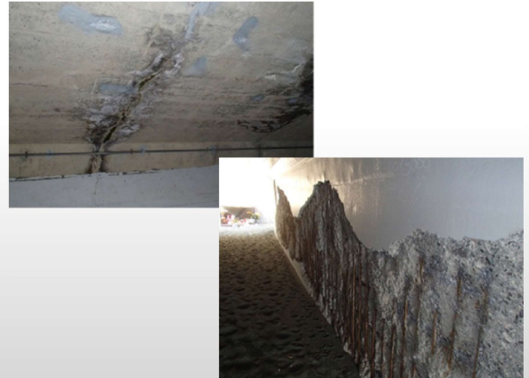
ボックスカルバートの損傷
