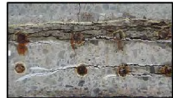
水平ひび割れ
