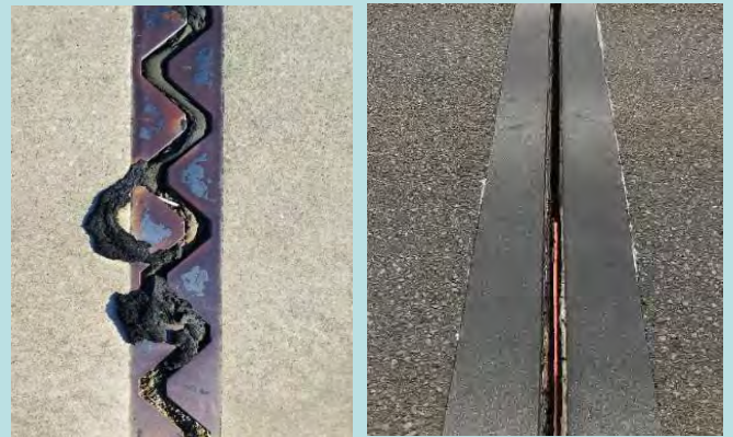
遊間部のゴム劣化の状況
