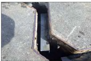
(1) 遊間部の損傷
