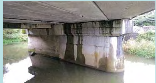
遊間部からの漏水状況
