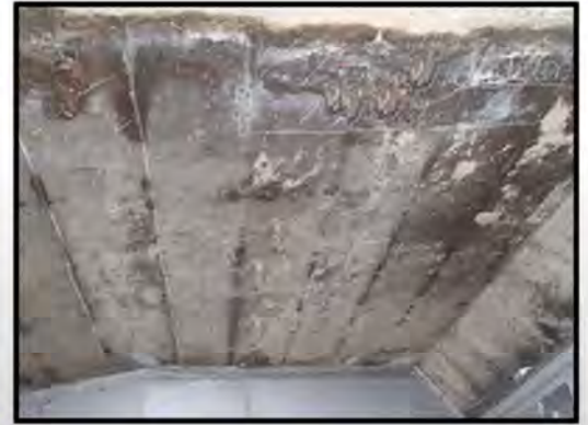
ボックスカルバート頂版の損傷
