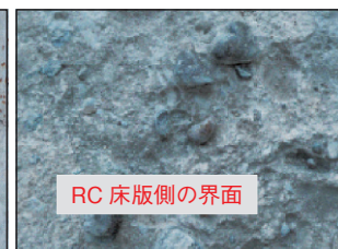
(3) 雨水が滞水しノロ発生
